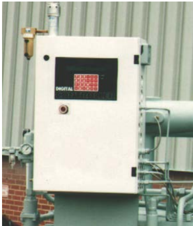
Retro air compressor controller.
